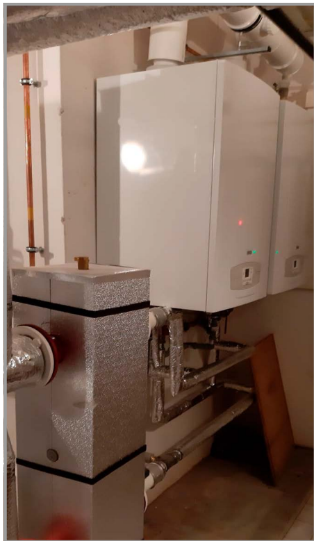
Součástí rekonstrukce byla také nová kotelna a další technologická zařízení
