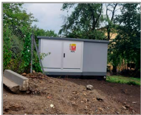
Nová trafostanice u horní autobusové zastávky
