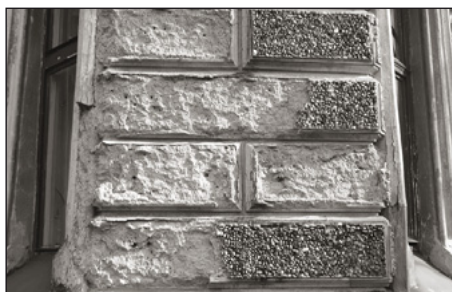
Stav bosáží před započatím restauračních prací.
