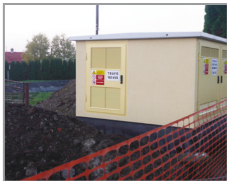
Nová kiosková trafostanice u rybníka.
